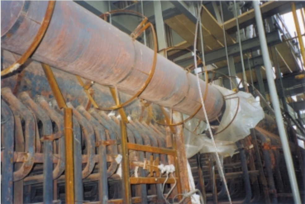
Cevovodi kolektorjev pare v Termoelektrarni Šoštanj so izpostavljeni predvsem lezenju
