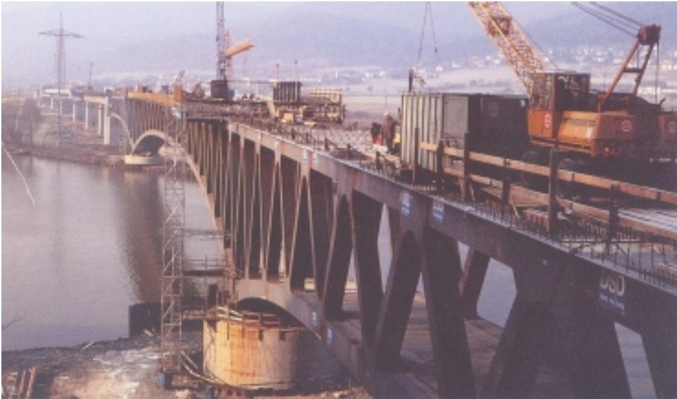
Kovinska mostna konstrukcija je izpostavljena korozijskim vplivom pa tudi dinamičnim obremenitvam, ki lahko povzročijo nastanek utrujenostnih razpok.
