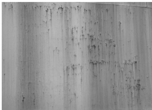
Slika 4: Poškodbe protikorozijske zaščite Figure 4: Degradation of paint coating
