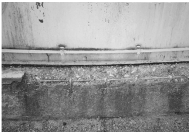
Slika 2: Degradacija betonskega temelja rezervoarja Figure 2: Degradation of concrete foundation
